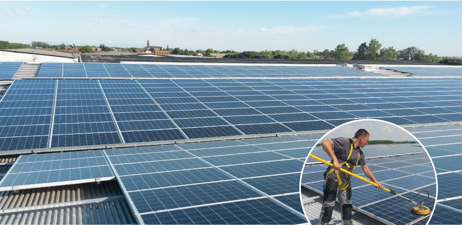
Dachanlage 864 kWp, Novara, Italien
