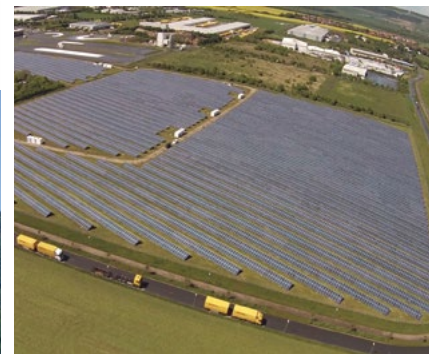
Instalacja naziemna 6.092,24 kWp Nohra, Niemcy
